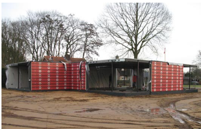
18. Grote openingen tussen de Star-Frame wanden i.c.m. warmgewalste hoeddraagconstructie.
